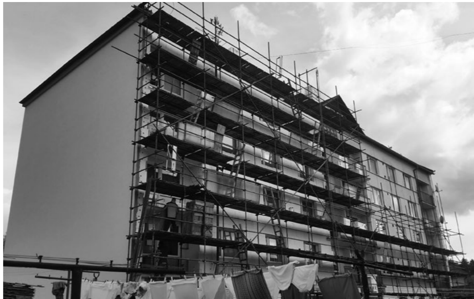
A „bílý“ panelák už není bílý, ale žlutý, snad mu to sluší víc. Rekonstrukci střechy a zateplení provedla firma D-BAU ze Semil.
